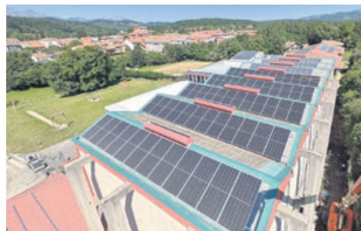
Mainondon, frontoiko eta eskolako teilatuetan dauden panel fotovoltaikoak. OREKA
